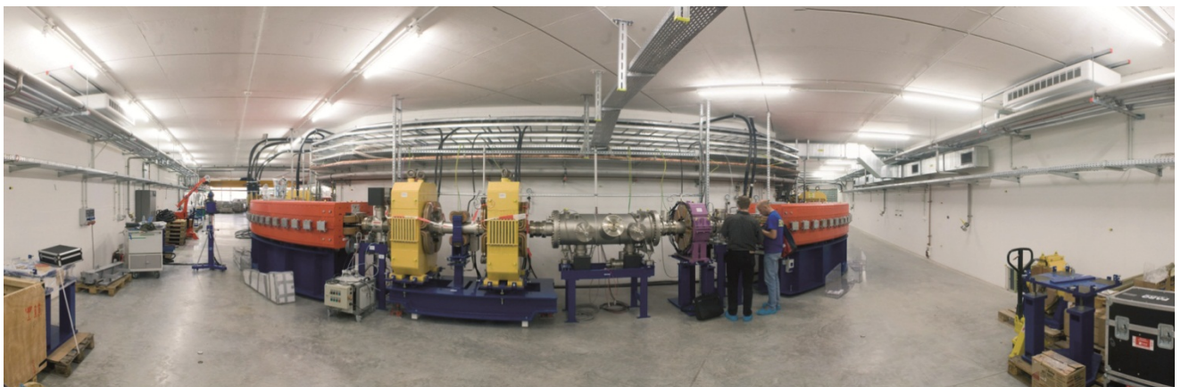
Ansicht von Synchrotronraum. Dipolmagneten (rot) links und rechts halten den Strahl in seinem Arbeitszyklus, wenn die Quadrupole (gelb) den Strahl fokussieren. (HIT-Therapieanlage, Heidelberg)
